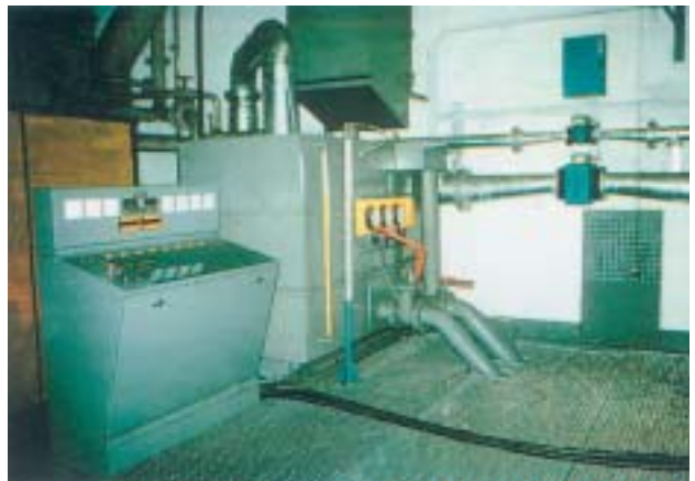
Установка для испытания насосов Объемная подача до 600 м 3 /час
